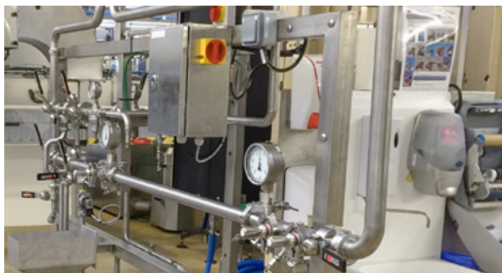
Photo 5A : Installation avec un tube inox à la place du filtre
